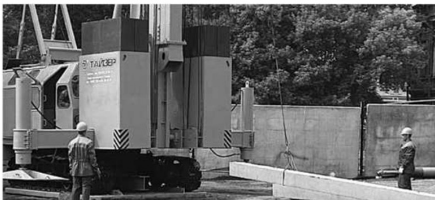
Рис.12. Общий вид установки СВУ В-6
